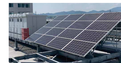
本社屋上設置の太陽光パネル
