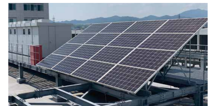
本社屋上設置の太陽光パネル
