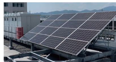
本社屋上設置の太陽光パネル
