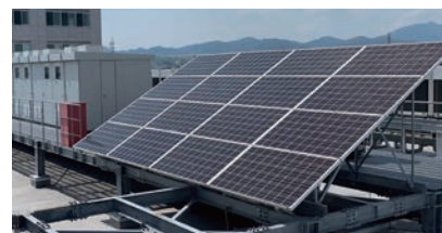
本社屋上設置の太陽光パネル
