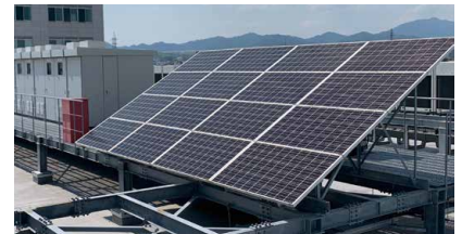
本社屋上設置の太陽光パネル
