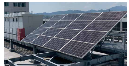
本社屋上設置の太陽光パネル
