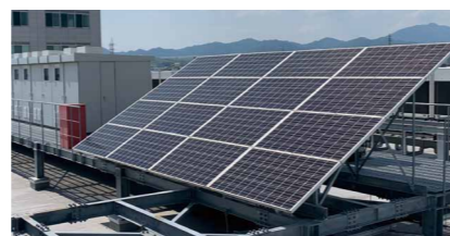
本社屋上設置の太陽光パネル
